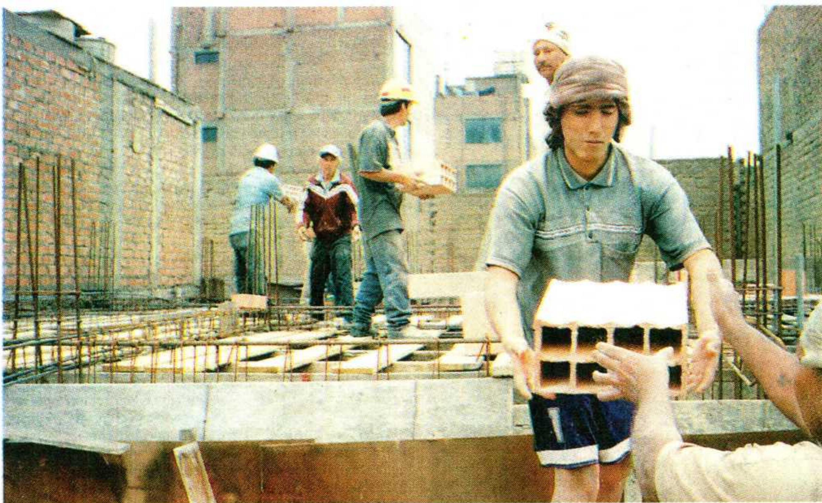
EN EL TECHO. El avance del sector constructor será básico para el desarrollo de la economía del Perú durante este año.
